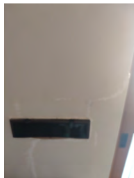
玄関内側のひび
